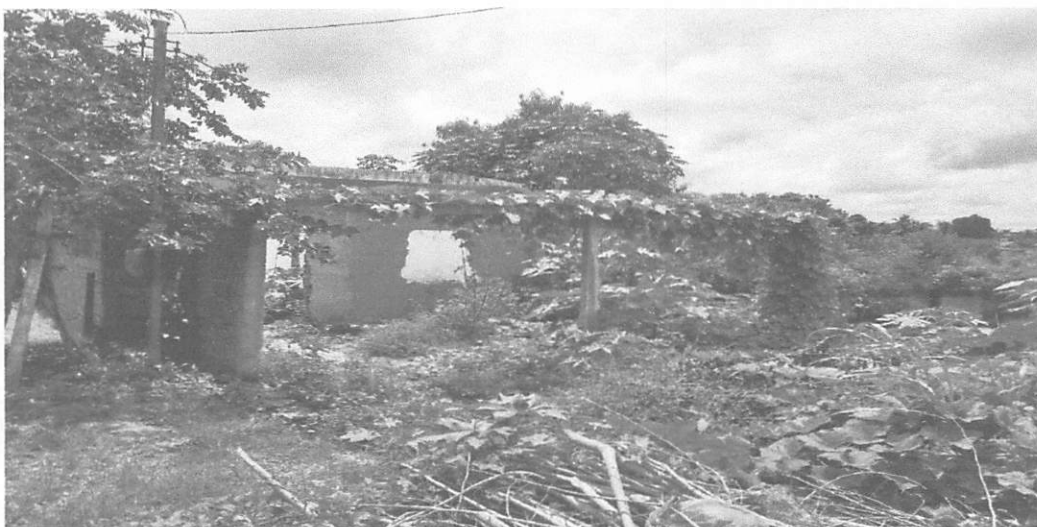
Casa própria do Sr. João Alves dos Reis localizada na Rua da Independência, nº 38, Centro, Buriticupu-MA.
